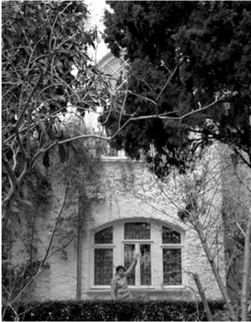
Трещина, проходящая сверху донизу
