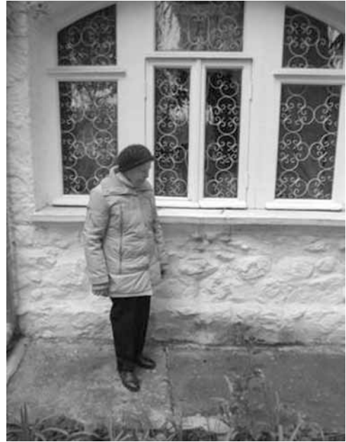
Эта трещина проходит и по отмосткам
